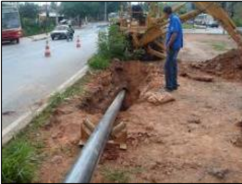
Tubulações enterradas ou submersa
