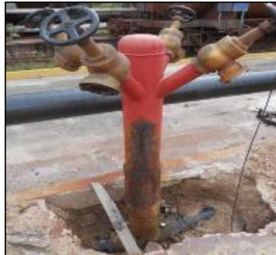
Rede de incêndio
