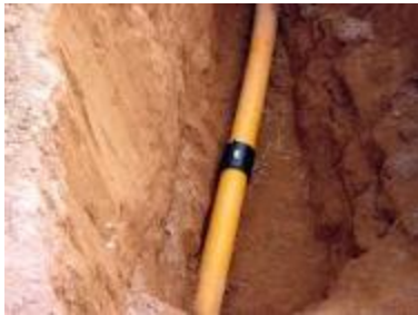
Tubulações de Polietileno
