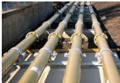
Tubulações de PRFV
